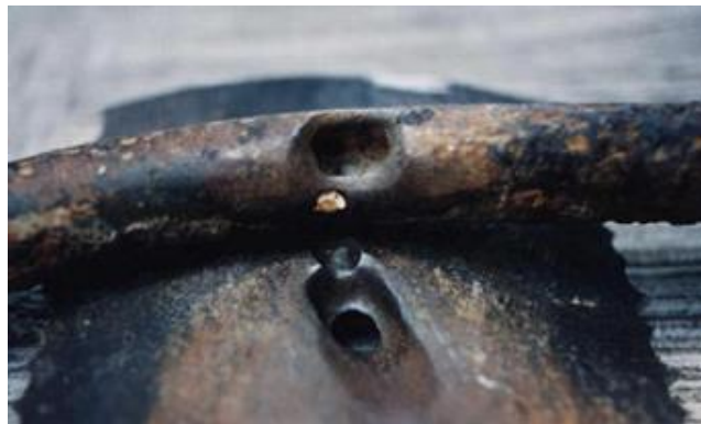
Figura 22. Tubería con agujero causado por corrosión por picadura
