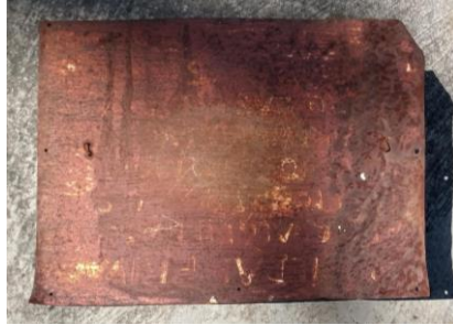
Figura 3. Fotografía lámina de metal que presenta corrosión.
