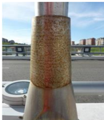
Figura 20. Poste con picaduras en el puente de las llamas.
