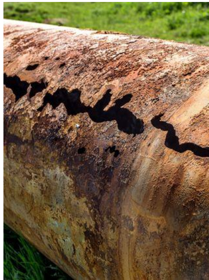
Figura 24. Tubería con ondulaciones y huecos causados por corrosión-erosión.
