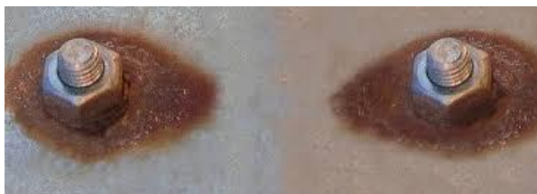
Figura 15. Corrosión galvánica, placa con tornillos
