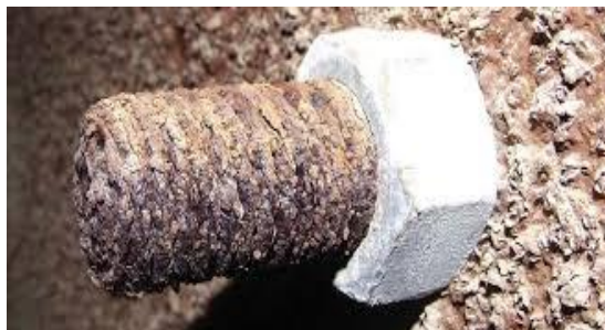
Figura 16. Corrosión galvánica, mismo caso que la figura anterior.
